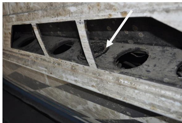
Zdjęcie nr 20. Niezabezpieczone otwory powietrza na półce kanału powietrznego
