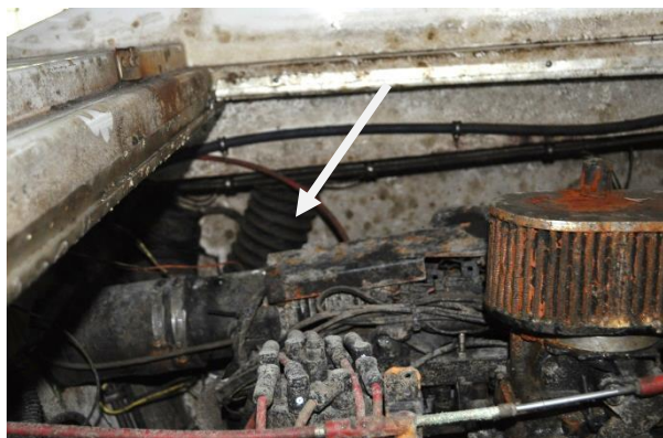
Zdjęcie nr 19. Jedna z istniejących rur gumowych służących do odprowadzania wody
