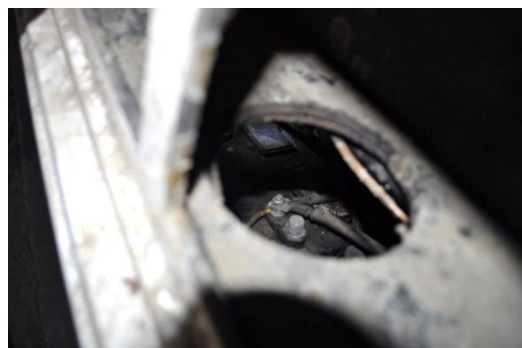
Zdjęcie nr 18. Odslonięty akumulator pod półką z otworami wlotów powietrza
