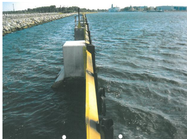
Zdjęcie nr 15. Spalone i osmolone odbojnice falochronu - widok z góry
