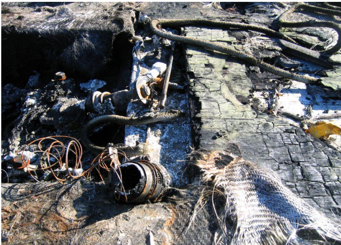
Zdjęcie nr 12. Pozostałości po przewodzie wlewu paliwa (na pierwszym planie)
