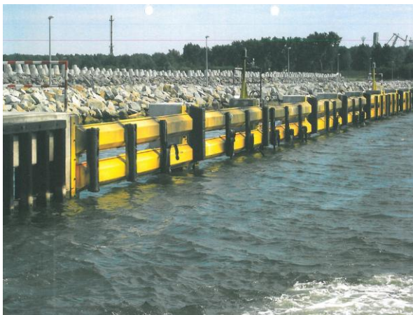
Zdjęcie nr 14. Spalone i osmolone odbojnice falochronu - widok z boku
